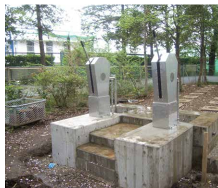
〔東京都練馬区 S公園〕 防災用・トイレ配管システム・樹木への水やりとして。
