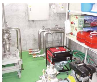
倉庫内配備状況
